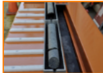
Alaves de refrigeración motor de la correa de traslación
